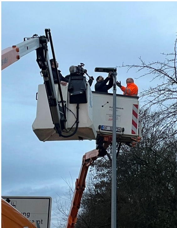
Energieminister Mansoori beim montieren eines smarten Sensors
