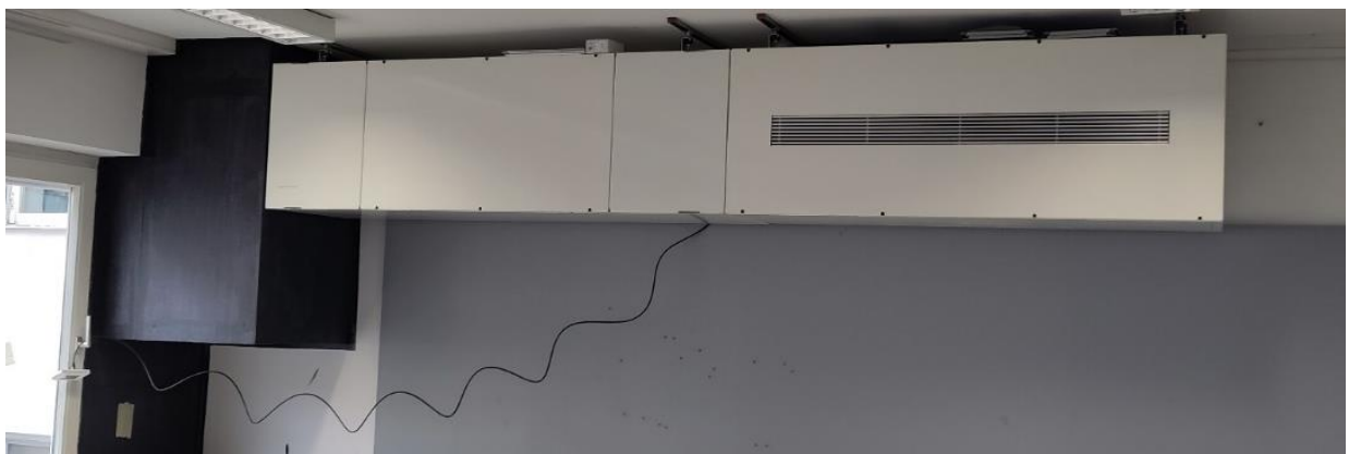
Abbildung 36: Lüftungsgerät und Luftkanal in fast fertigem Zustand, © Passivhaus Institut
