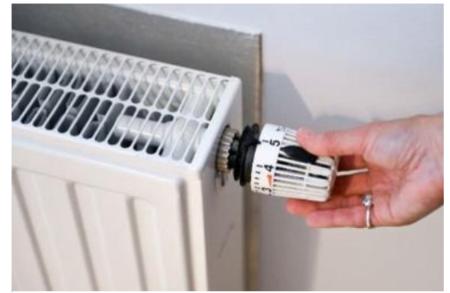
Abbildung 40: Das Herunterdrehen des Heizkörperthermostats, z.B. von 5 auf 2, bewirkt eine Temperaturreduktion und damit eine Energieeinsparung. © LEA-Hessen/Rundel
