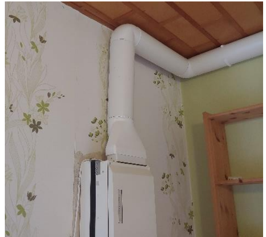
Abbildung 35: Das Lüftungsgerät ist an der Außenwand installiert, eine Abluftleitung führt die Luft aus dem Badezimmer zum Gerät. © Passivhaus Institut
